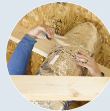
密封洩漏的空氣管道
